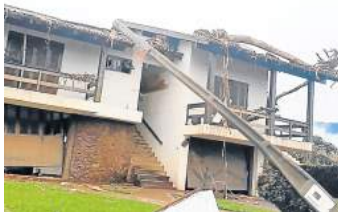
A árvore foi parar acima do telhado da casa
